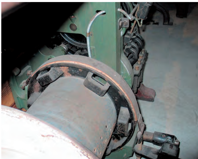
Figura 8 - Telaio a navetta con frenatura continua del cilindro dell'ordito (subbio): freno a nastro mantenuto in tensione con un sistema di leve e pesi. Si nota la guarnizione biancastra in tessuto di amianto fissata con chiodatura
