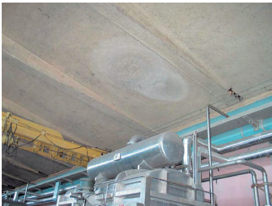
Figura 5 - Soffitto con rivestimento in amianto alterato da getti di vapore in pressione. La sottostante vasca di tintoria mostra le moderne coibentazioni delle tubature che erano in precedenza in amianto a vista
