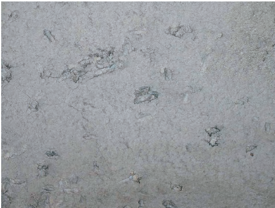
Figura 1 - Soffitto di tintostamperia rivestito di amianto spruzzato (amosite): sono evidenti le alterazioni dovute a urti con oggetti solidi
