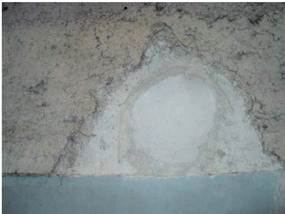
Figura 4 - Parete di stabilimento di tessitura coibentata da strato antirumore di amianto (amosite) fino ad altezza d'uomo: area alterata da un intervento murario di eliminazione di un passaggio di tubi
