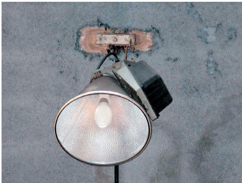
Figura 2 - Soffitto di tintostamperia rivestito di amianto spruzzato (crocidolite): sono evidenti il colore bluastro, le asportazioni dovute a modifiche dell'impianto elettrico ed altre da urti
