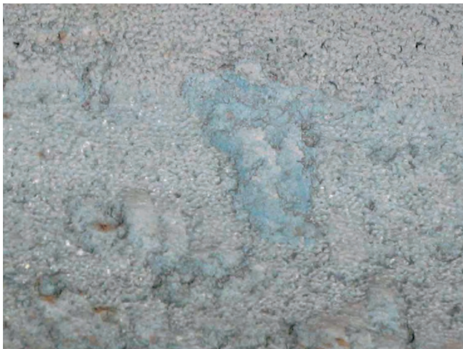
Figura 3 - Particolare della situazione riportata in figura 2: ben visibili i fenomeni di sfioccamento dell'amianto blu
