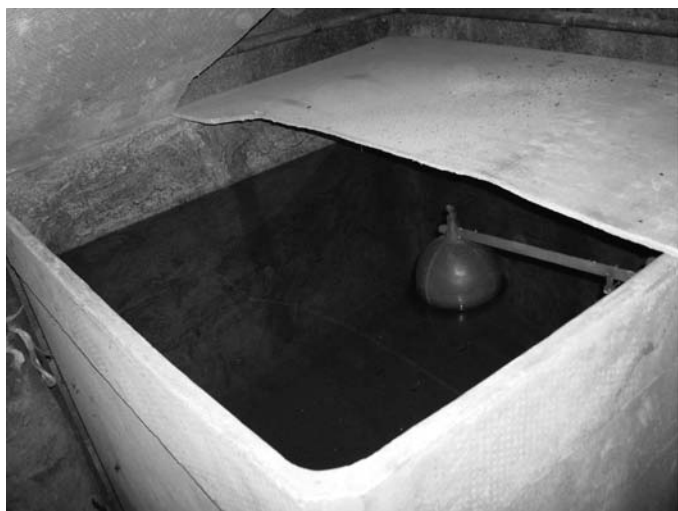
Fig. 1. Serbatoio di raccolta di acqua per usi domestici in cemento-amianto
